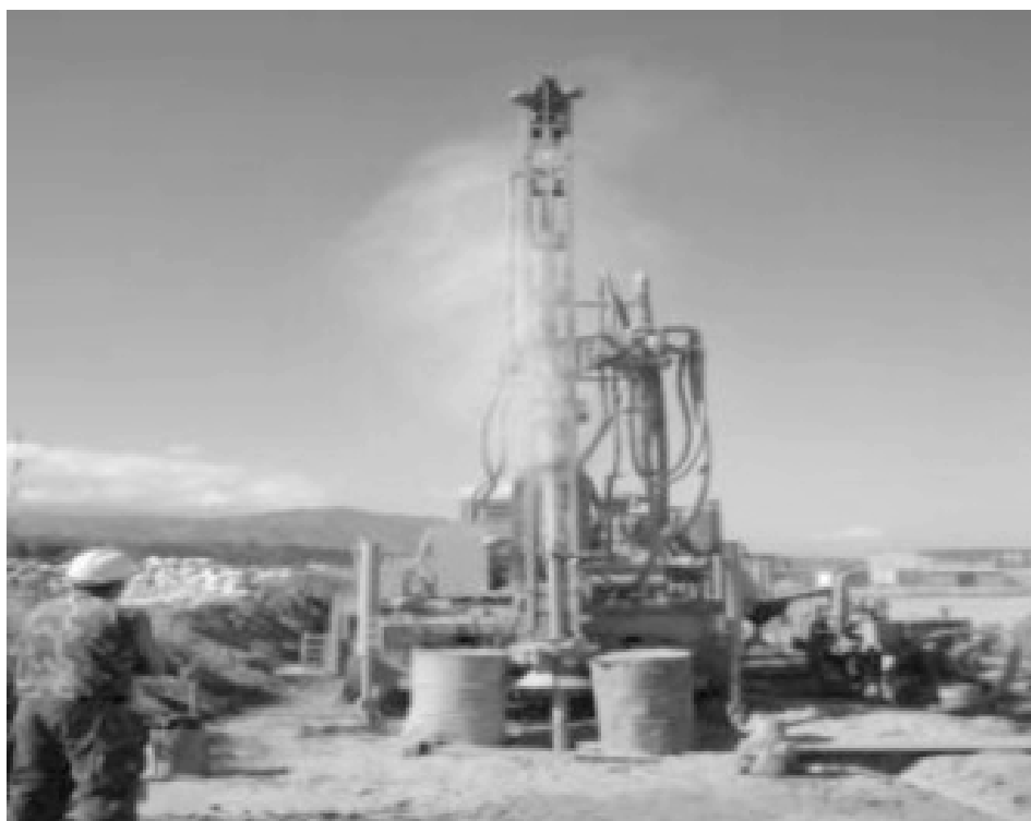
Foto: Perfuração de poço pela Companhia de Engenharia no Haiti (Arquivo CCOPAB)
